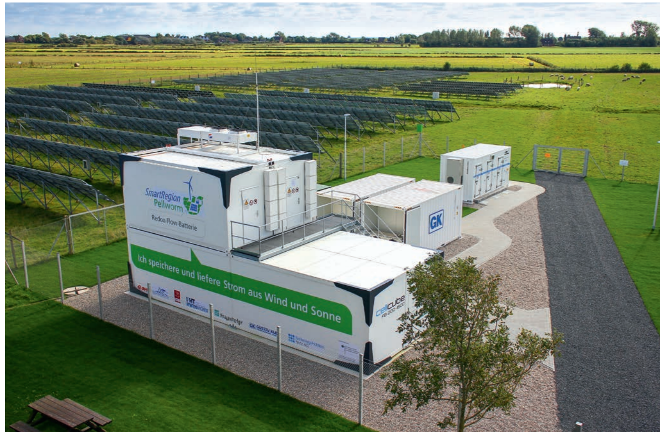
Das Solarfeld auf Pellworm mit dem Großspeicher, der Redox-Flow-Batterie
