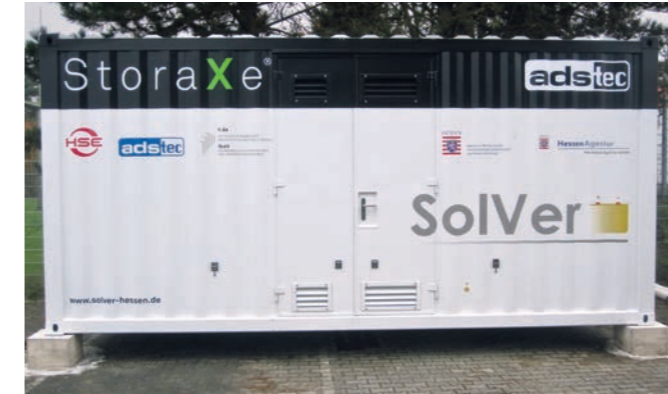
Einer der Batteriespeicher, die im Rahmen des SolVer-Projekts in die Handelsplattform integriert wurden
